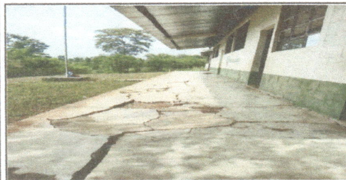
Foto 5: Deterioro del corredor del Establecimiento.
